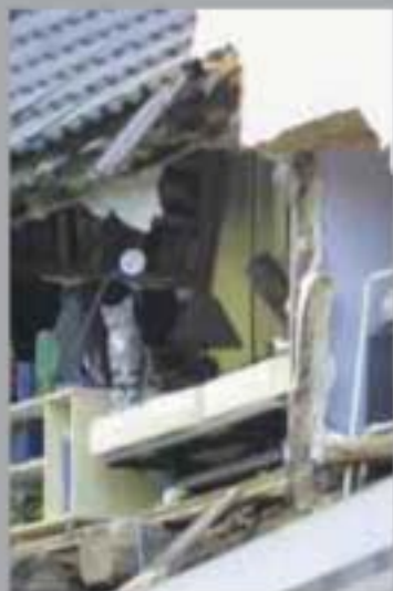
Plötzlicher Hausseinbruch – Bewohner und Katze kamen mit dem Schrecken davon.
